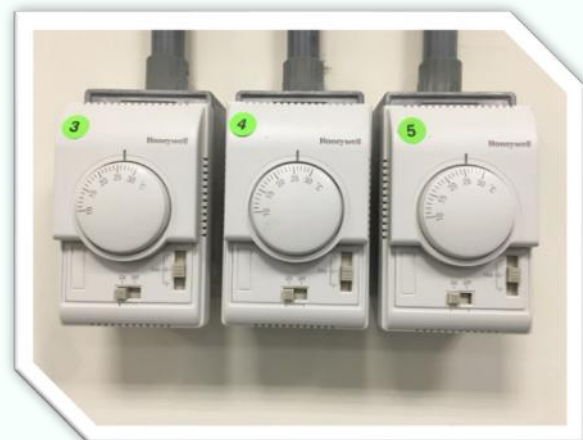
空調採用恆溫裝置
